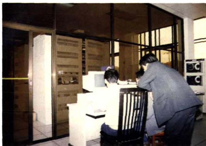
进口日本 F - 150 型 5000 门程控交换机 设备
