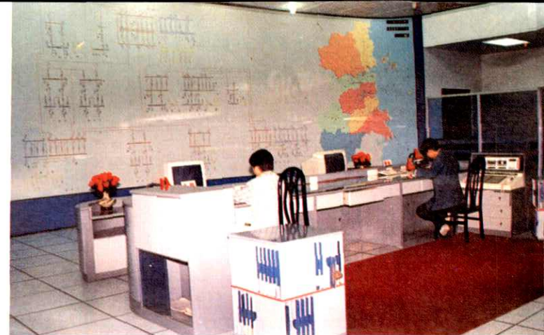
温州电业局电力调度室
