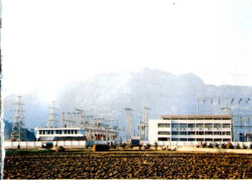
220 千伏垂杨变电所
