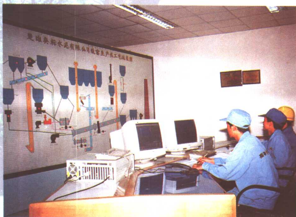
楚雄奕标水泥 有限公司DCS旋窑 计算机中央控制室
