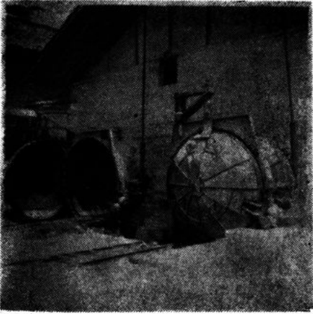
洪雅县航运公司砂砖厂 Ø2×7蒸釜
