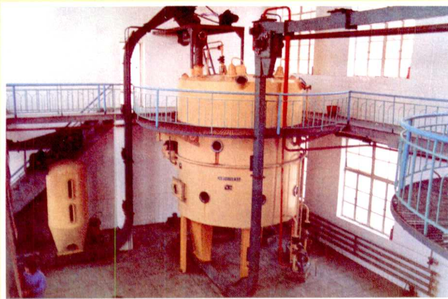
(图 6-16)市榨油厂浸出油车间浸出器
