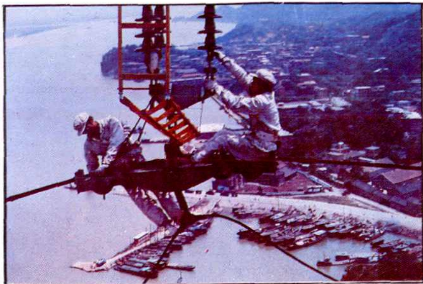
赣西供电局 220KV 珠 珊变电站
