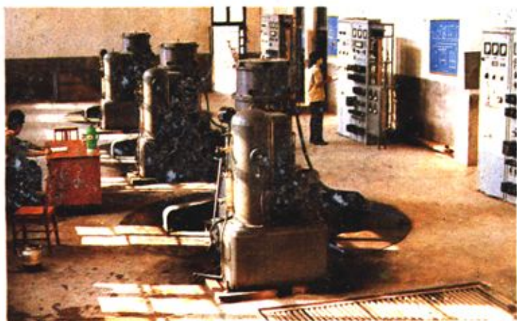
许家崖水电站机房装机情况
