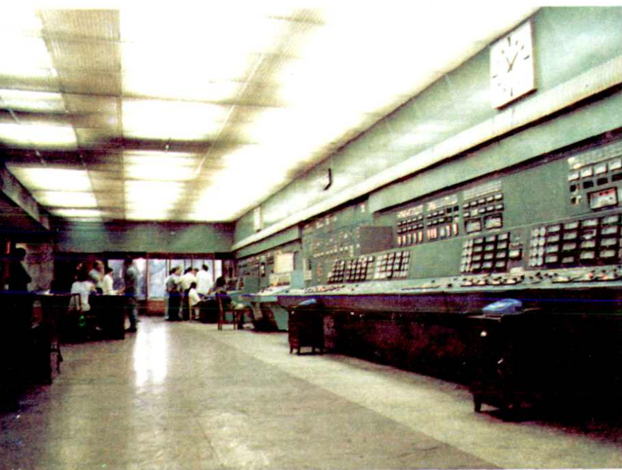
八、厂区集控室
