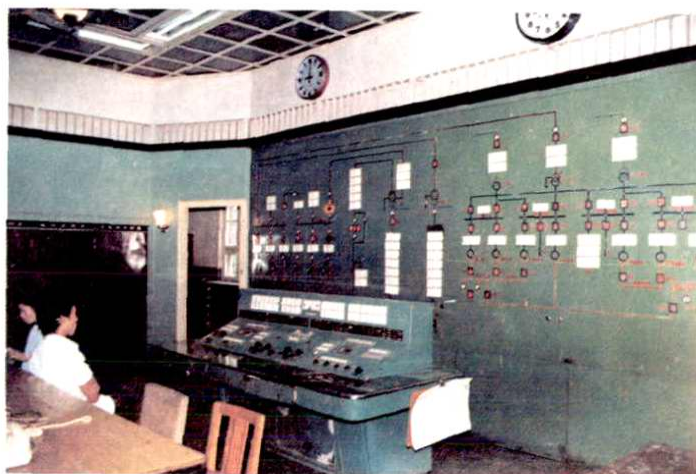
十八、一电站电控室
