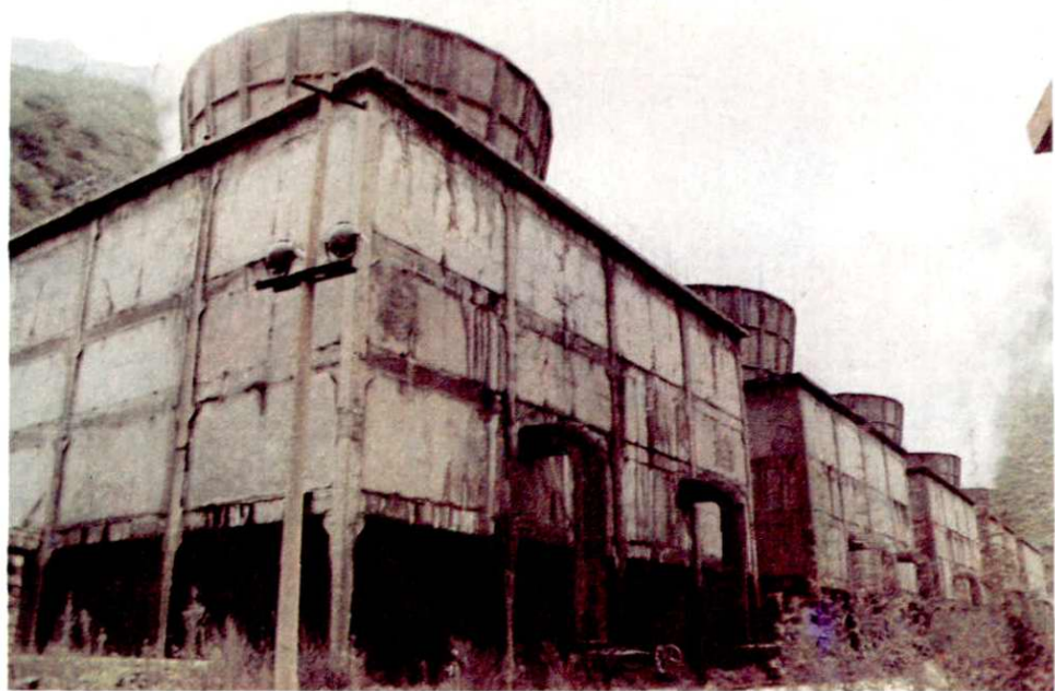
二十、一电站机力塔
