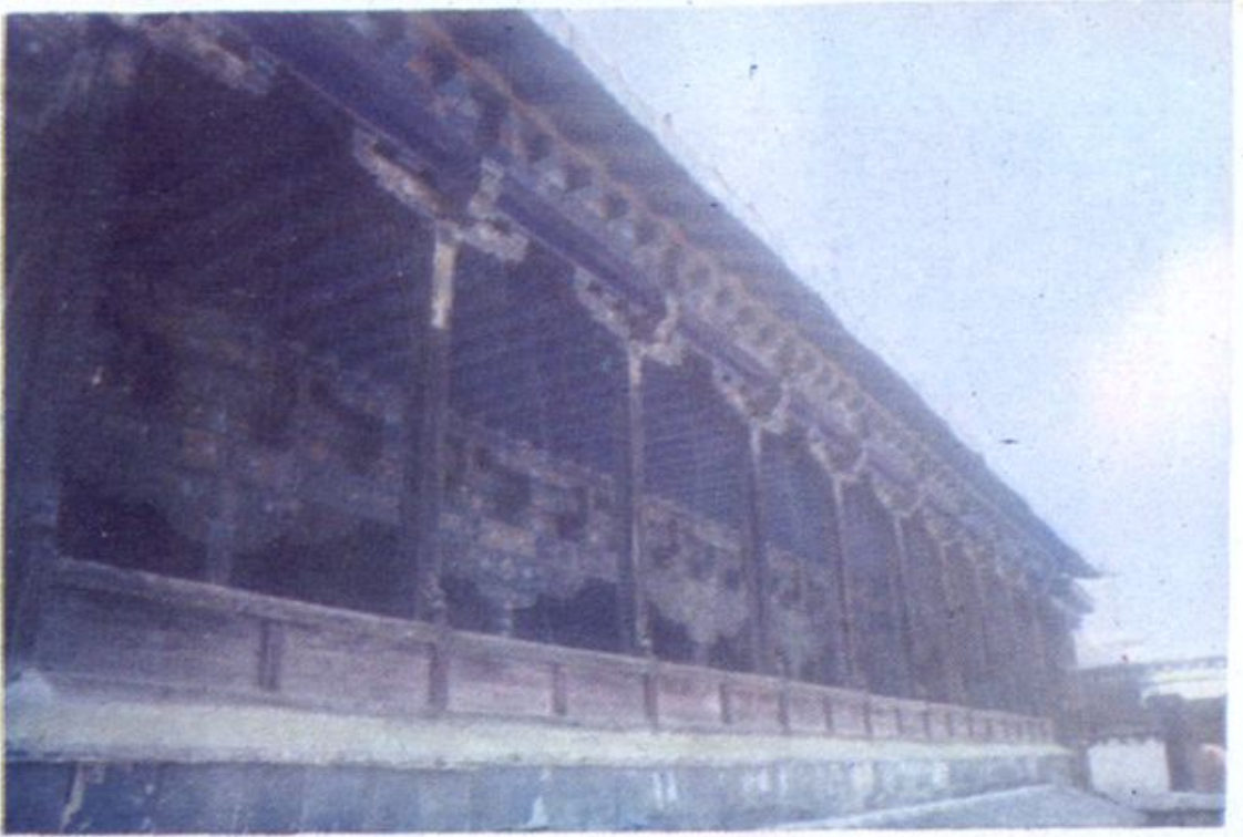
图四：“乌孜”大殿中层明廊的斗拱及铁丝网
