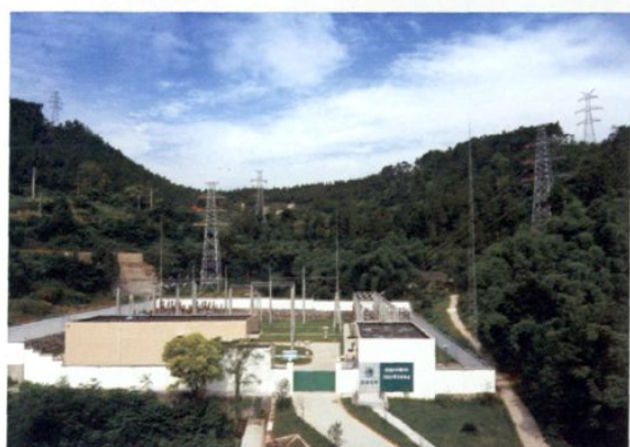
110千伏蟠龙变电站
