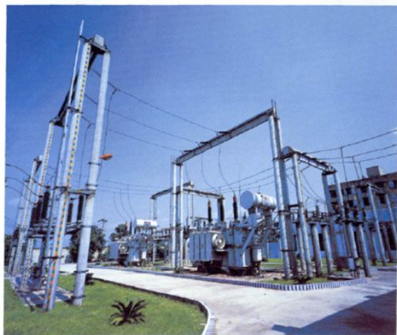
110千伏城南变电站
