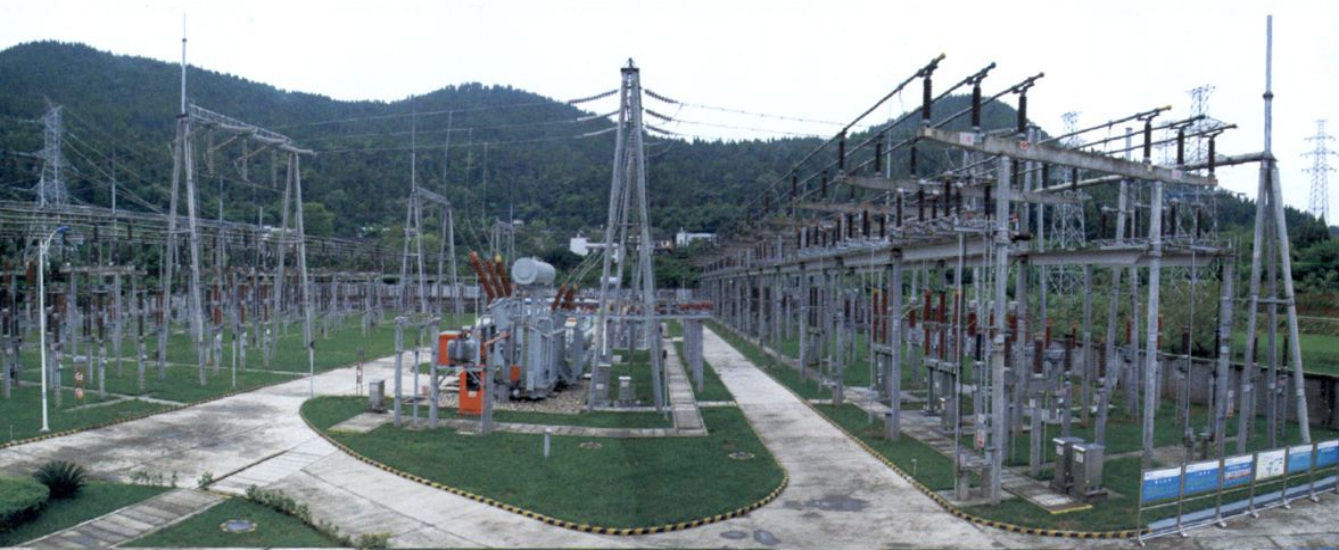
220千伏万林变电站
