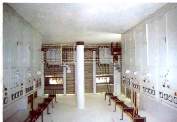
长江水泥厂配电房一角
