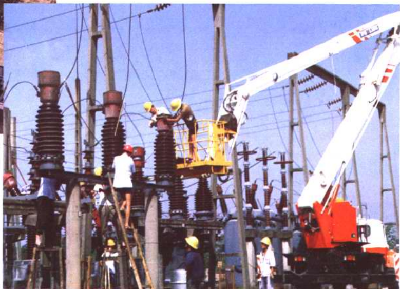
右为检修维护 变电高压设备
