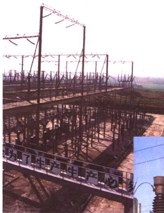
上为220千伏梅庄变电站户外场景
