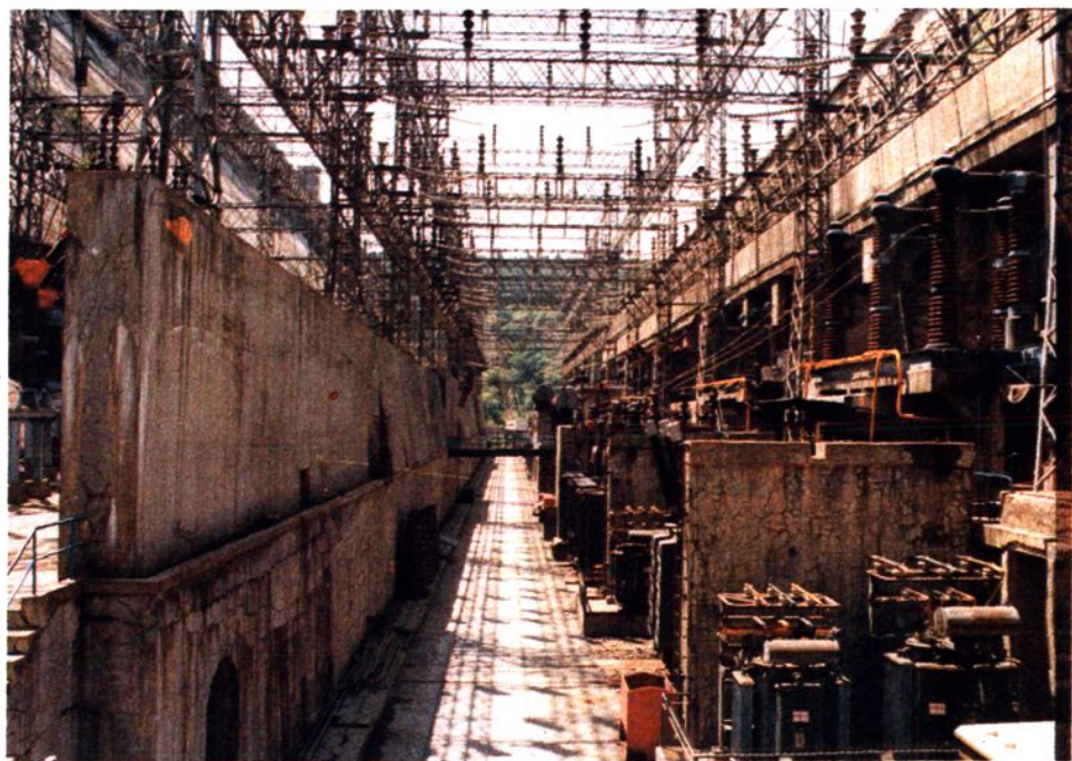
丰满发电厂变电所
