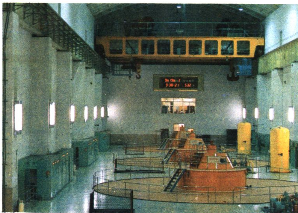
白山发电厂地下水电站发电厂房
