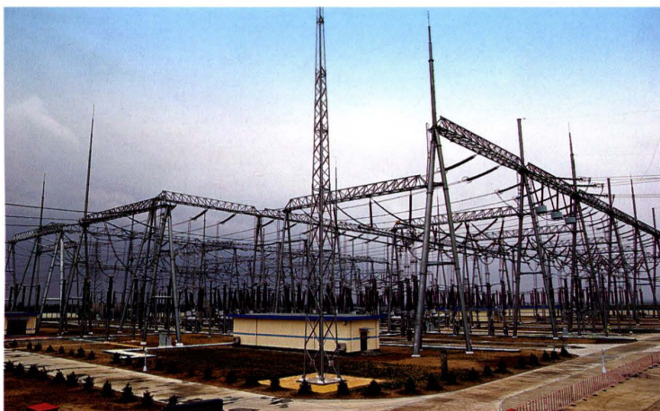
旗台500KW变电站
