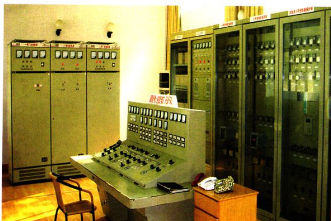
东阳化肥厂热电厂 3000 千瓦汽轮发电机组
