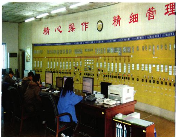
220 千伏东阳变电所金东大集控站
