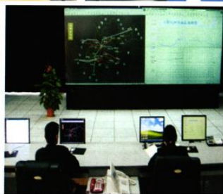
东阳市供电局电力调度室
