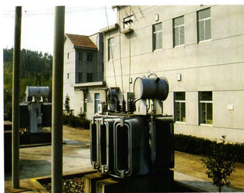
第一座按自动化设计建设的室内式 35 千伏罗峰 变电所
