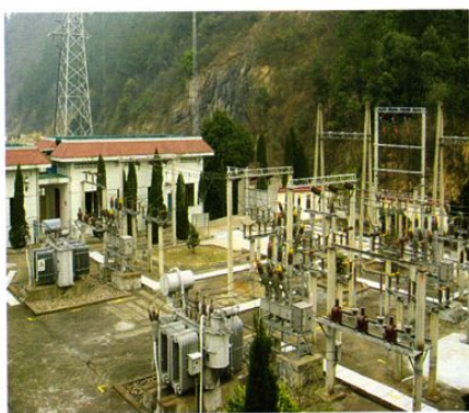
35 千伏眠牛山变电所全景
