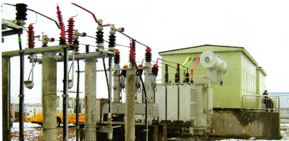
35 千伏湖头陆箱式变电所
