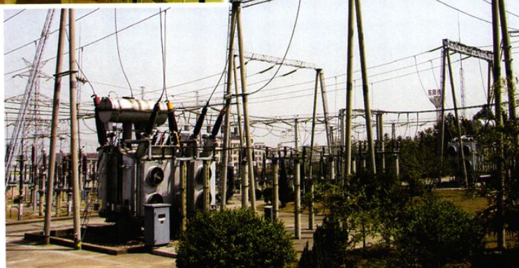
220 千伏东阳变电所
