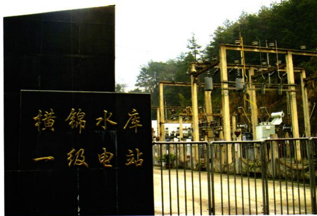
横锦水库一级电站
