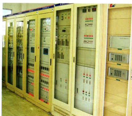
第一座按综合自动化设计建设的 110 千伏 巍山变电所主控室
