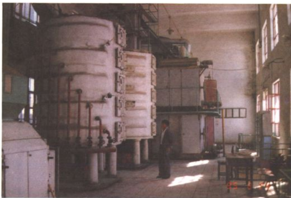
浸油厂预处理车间
