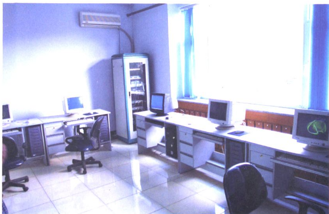
网站主控机房
