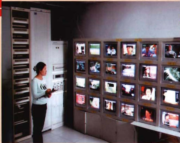
平陆电视台数字微波机房
