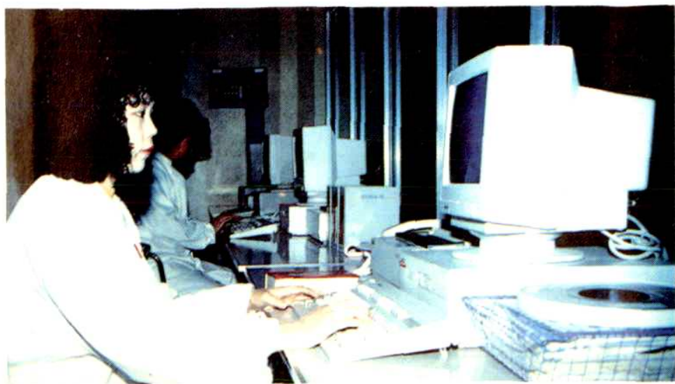
伊克昭盟邮电局市话程控机房
