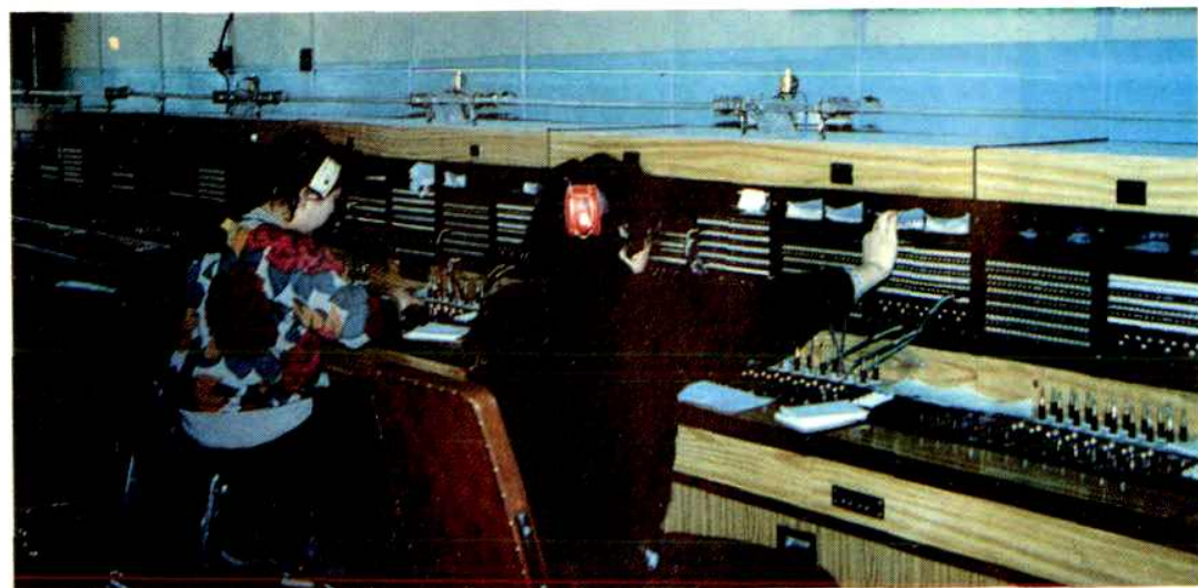
伊克昭盟邮电局长途电话接续台
