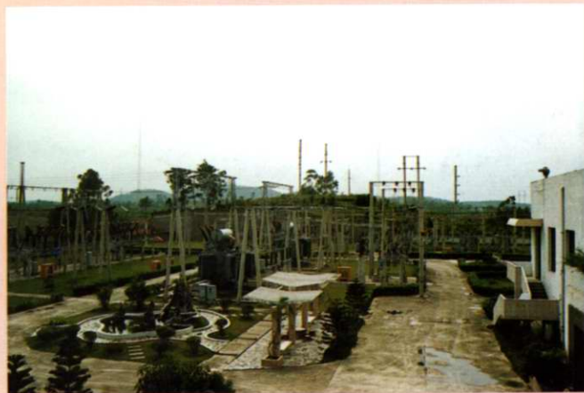
▽城南110千伏变电站
