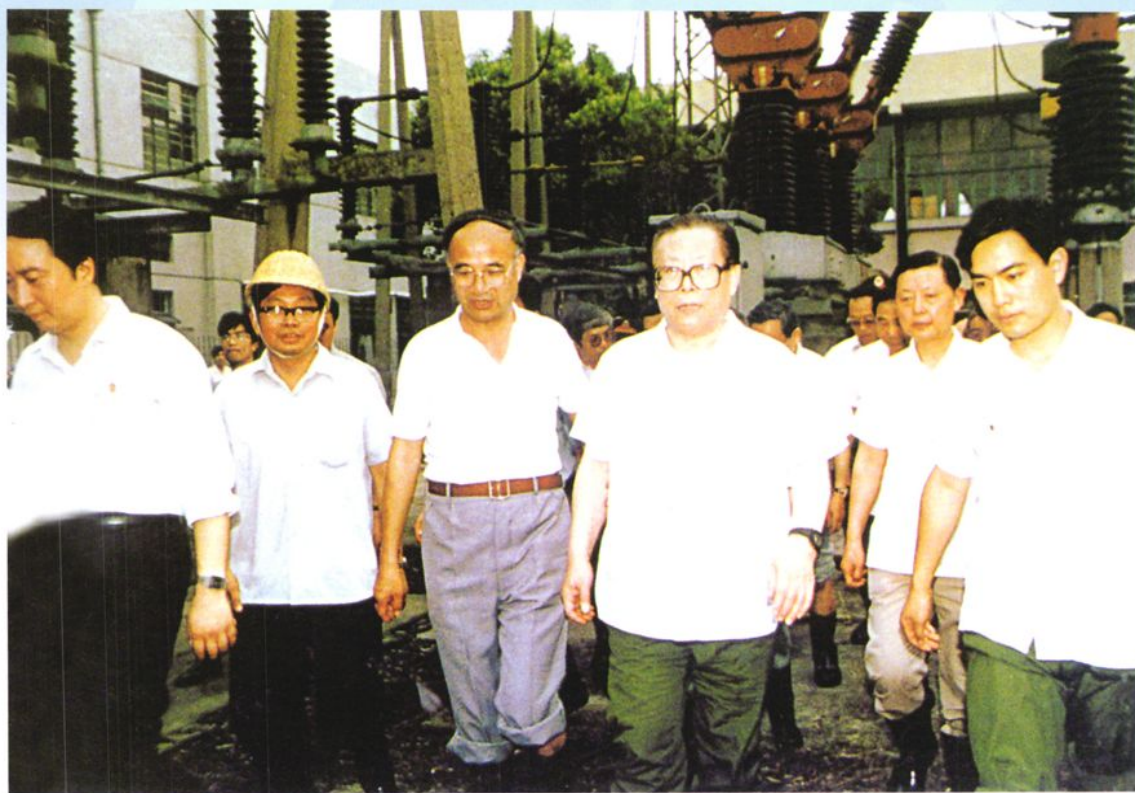
①1991年7月9日17时零5分,中共中央总书记江泽民(前左四)亲临苏州城西南胥江河畔被洪水包围的110千伏胥门变电所,涉水视察水灾情况
