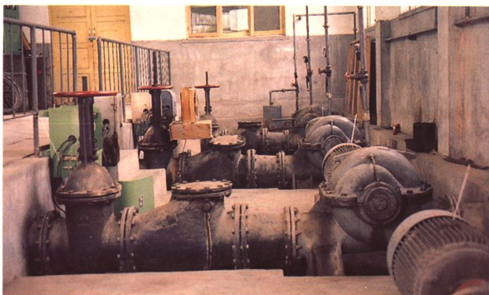
汉惠渠南干渠抽水站机组
