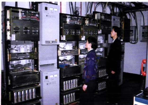
移动通信机房
