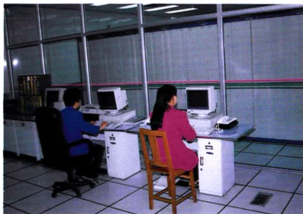
武穴局万门程控机房的一角
