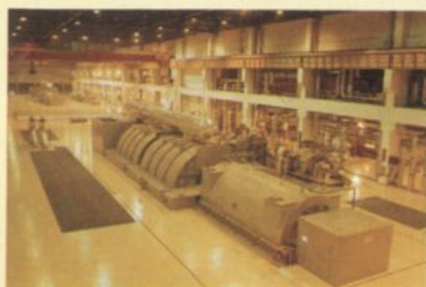
全国首台通过国家电力公司达标投产验收的 600MW 汽轮发电机组。
