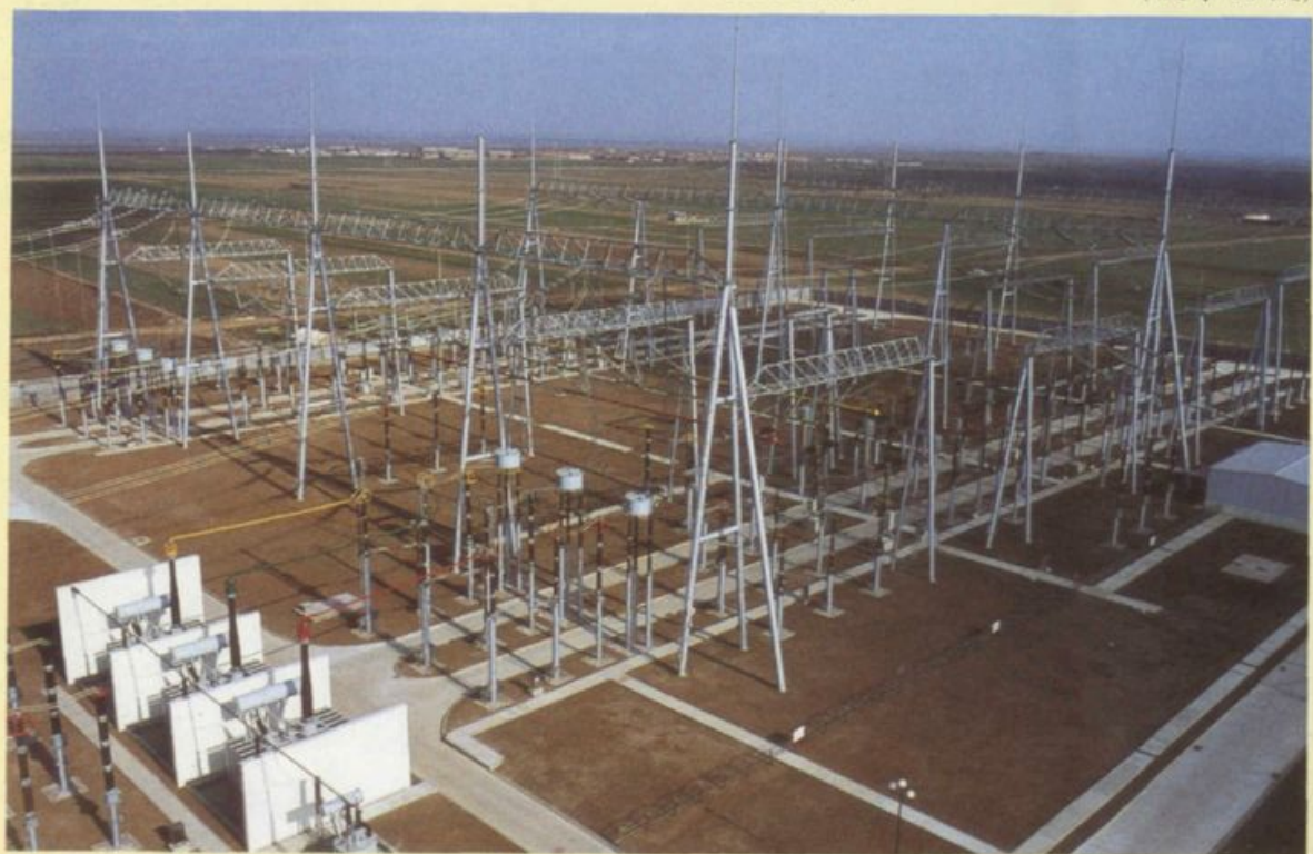
公司承建的青岛崂山变电站 (500KV)。
