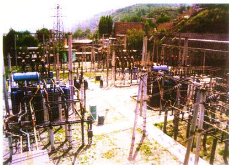
杜儿坪 110 千伏高压变电站
