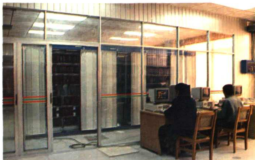
程控电话机房
