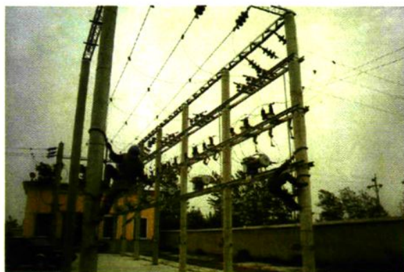
35千伏顺河变电所
