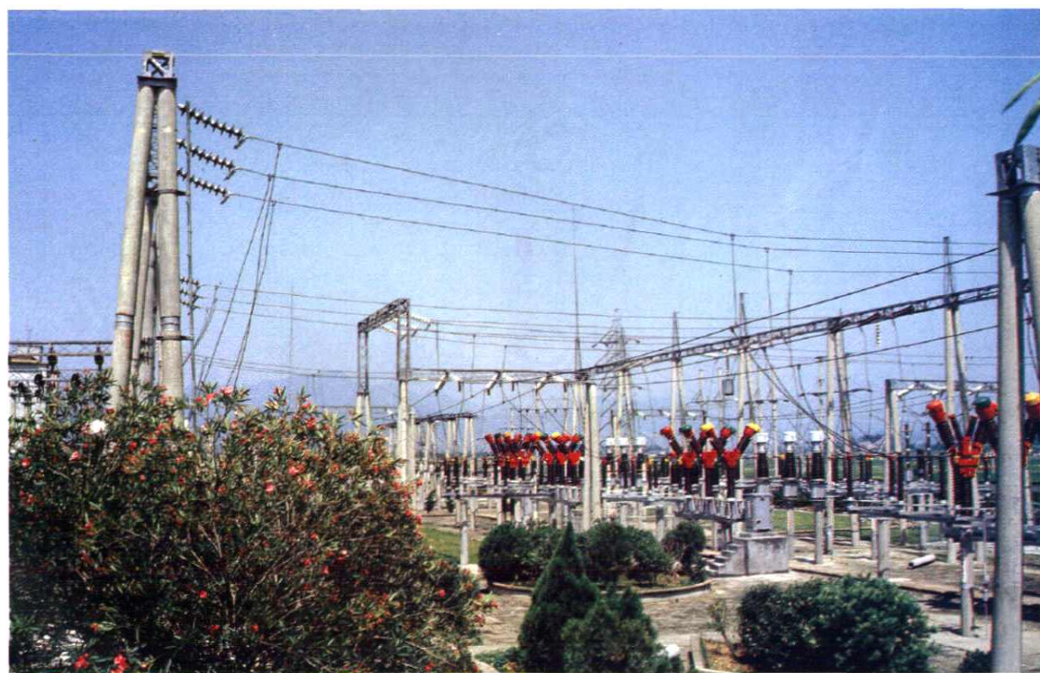
110 千伏古市变电所,变电容量 2 万千伏·安
