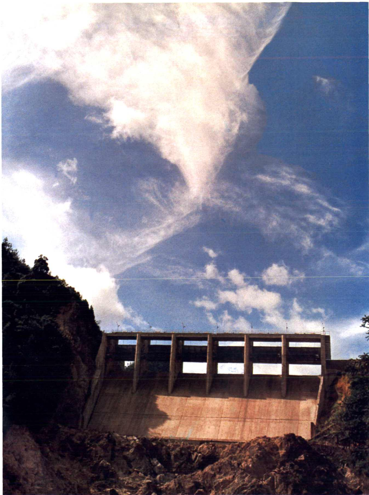
遂昌成屏一级水电站,装机容量 8000 千瓦
