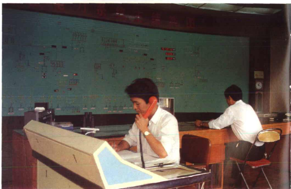
丽水地区 电力调度室
