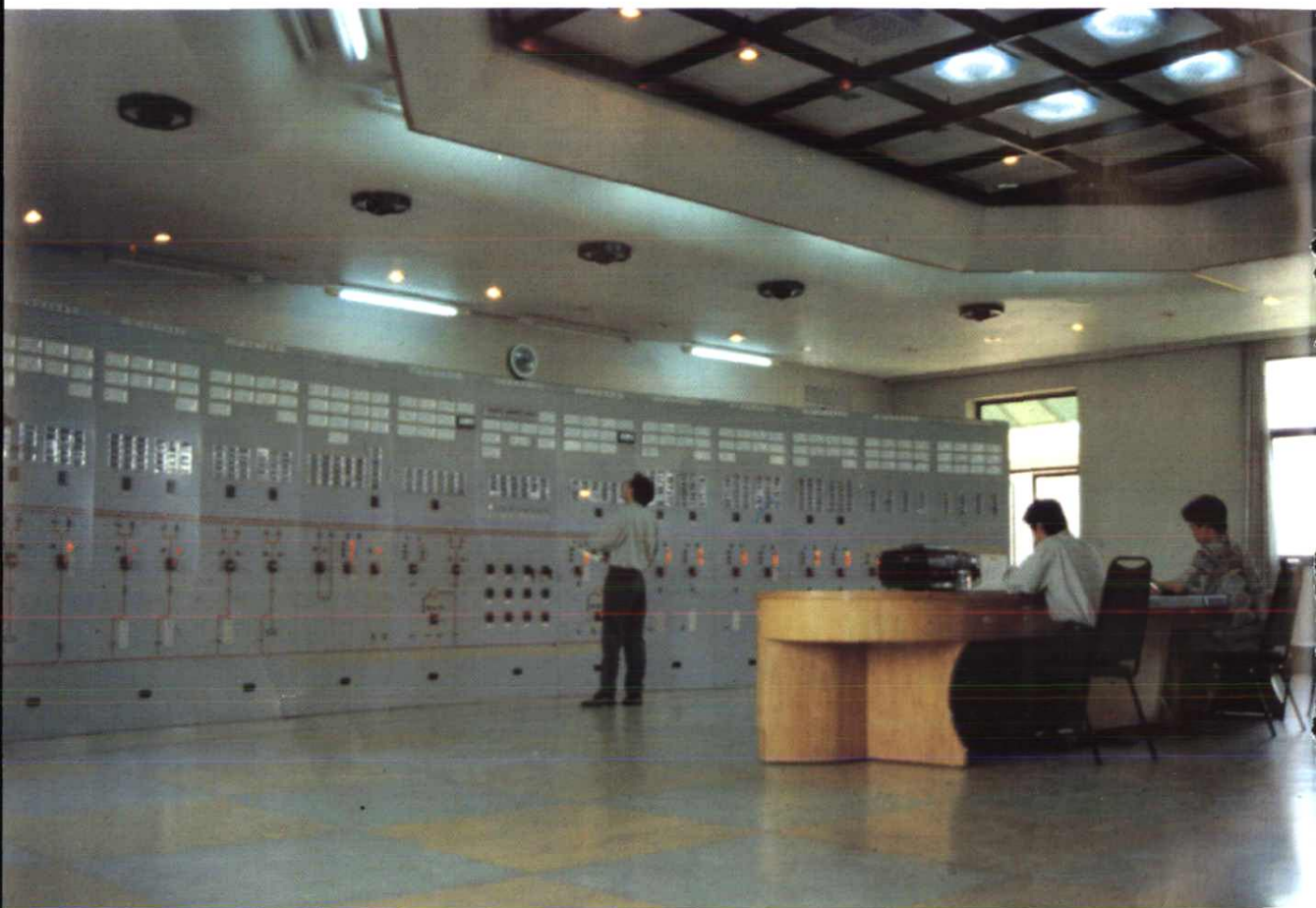
220 千伏丽水变电所, 变电容量 9 万千伏·安
