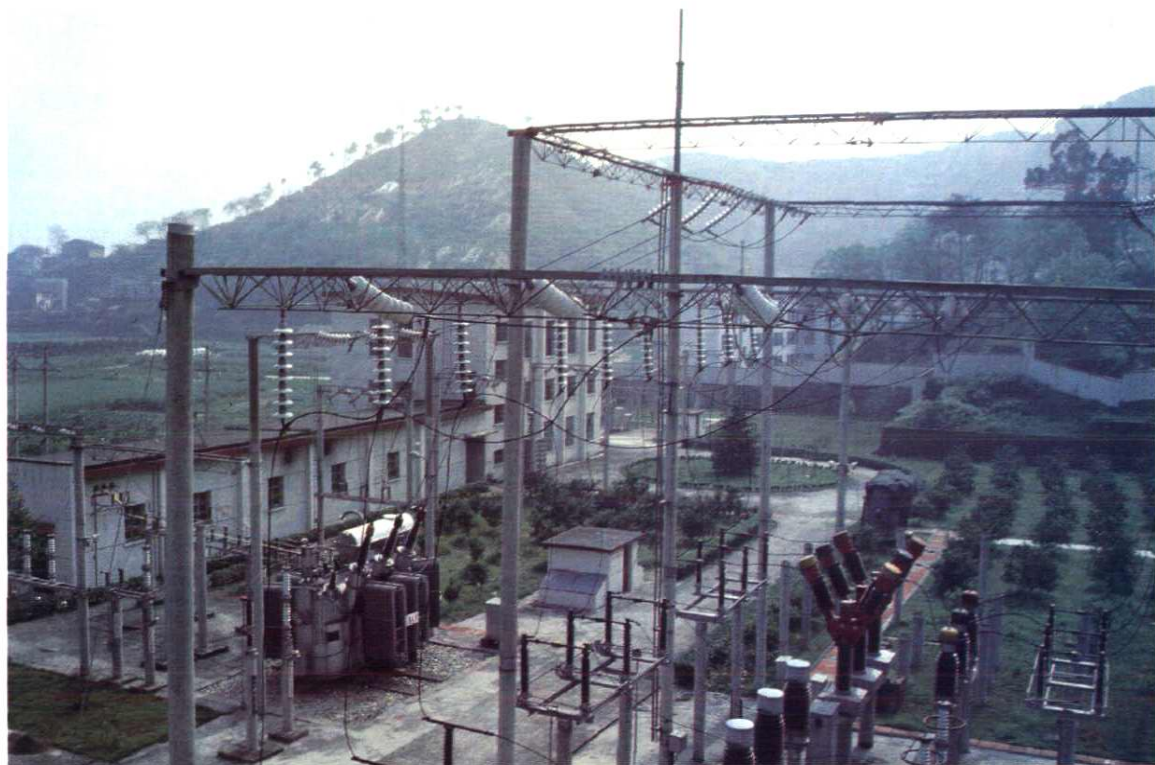
110 千伏温溪变电所,变电容量 2 万千伏·安
