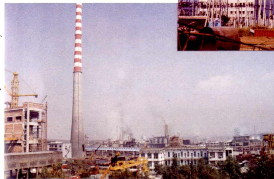
公司承建的江西新余发电厂远眺
