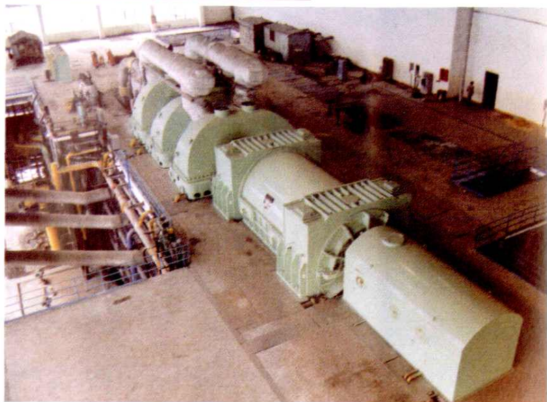
1989年公司承建的江苏常州 戚墅堰电厂 2 \times 20 万千瓦发电机 组工程。图为 1 号机组
