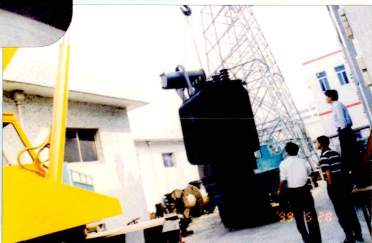
丹阳自来水公司每年在供水 高峰前对设备进行检修、维护， 以确保供水安全可靠
