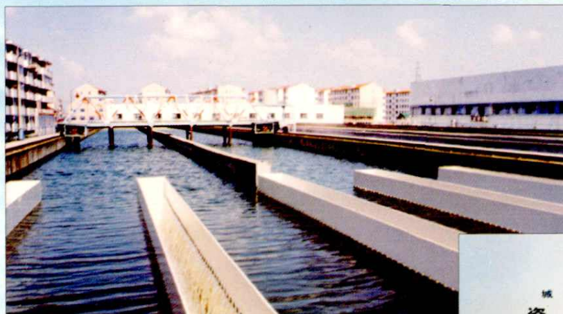
丹阳自来水公司供水三厂
