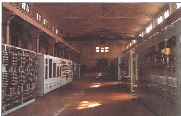
水汽取样装置装配车间
