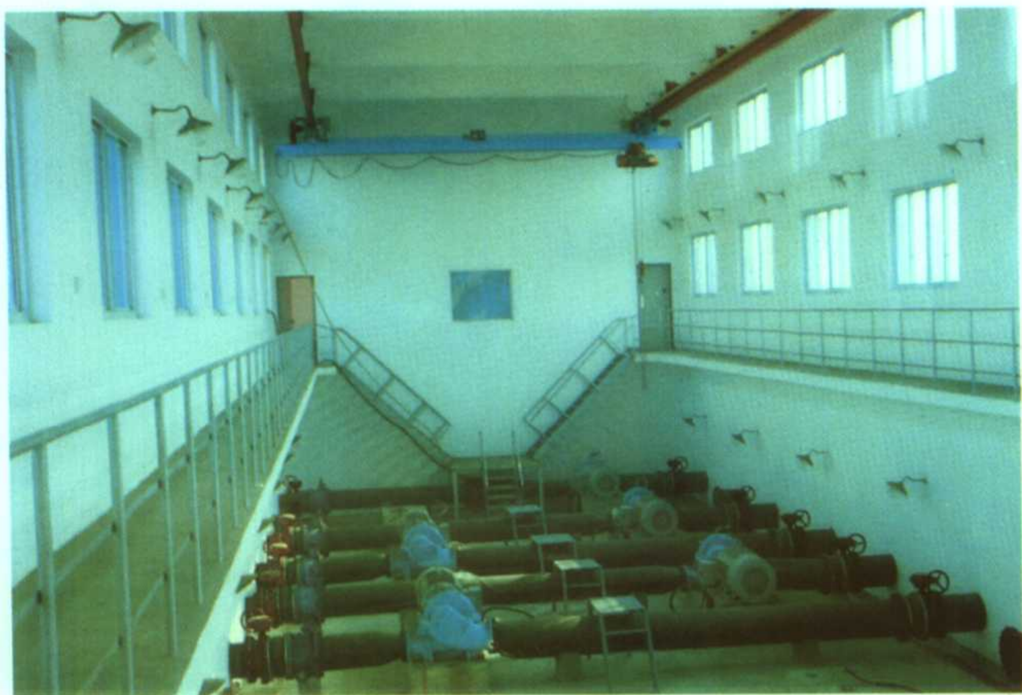
日供水能力5万吨的第二水厂泵房
