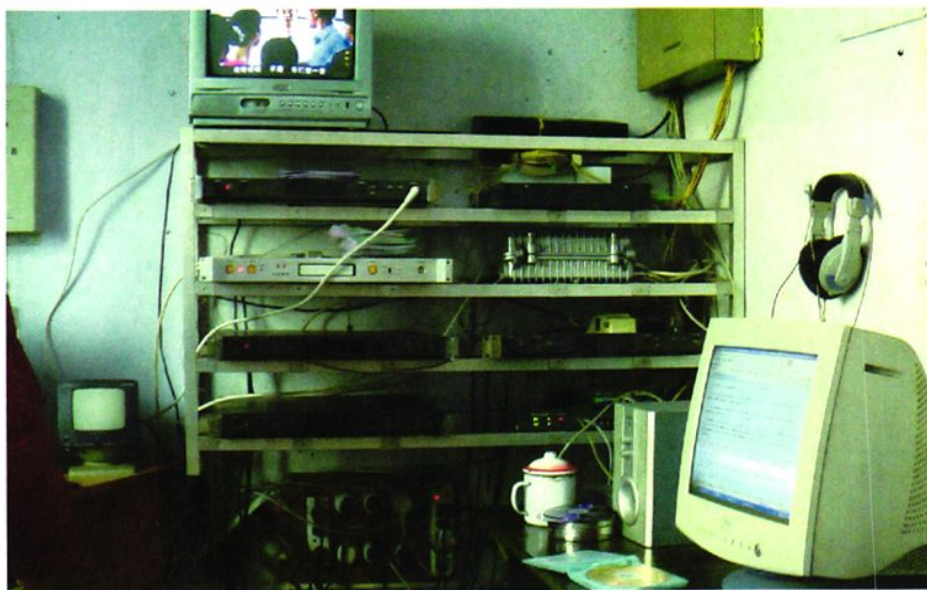
中天镇广播电视站 (机房)
