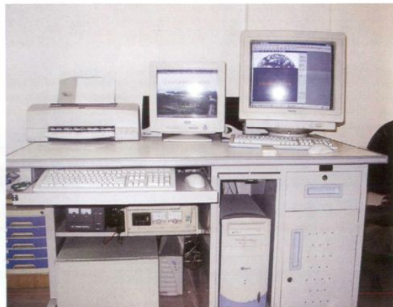
◎ 水库供水自动测报系统。
