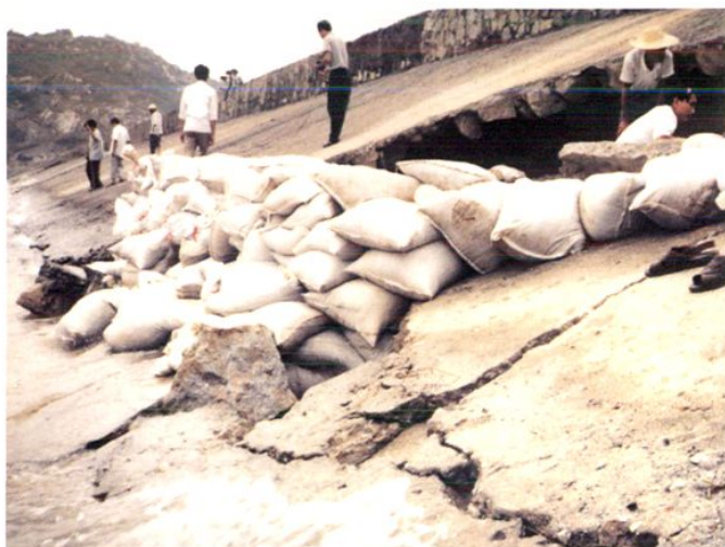
◎ 1993年，台风损坏台山市桂南水库坝体。
