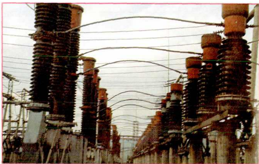
▶ 金竹山电厂220千伏变电站
