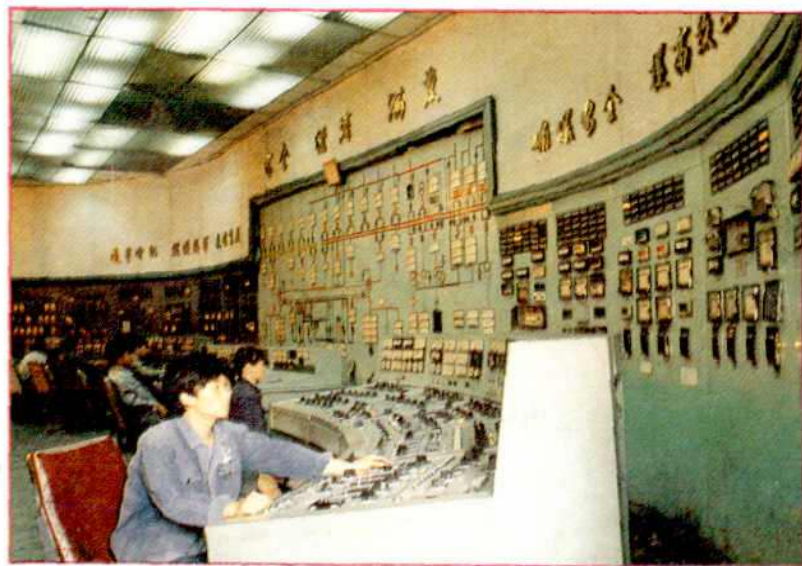
◀ 金竹山电厂控制室
