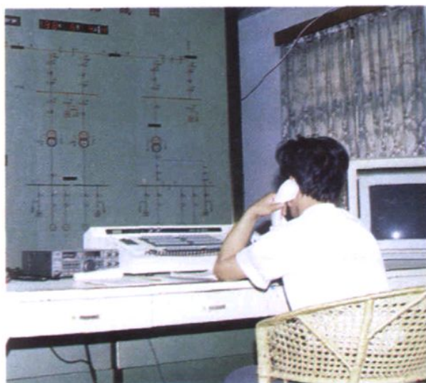
金溪流域调度室
