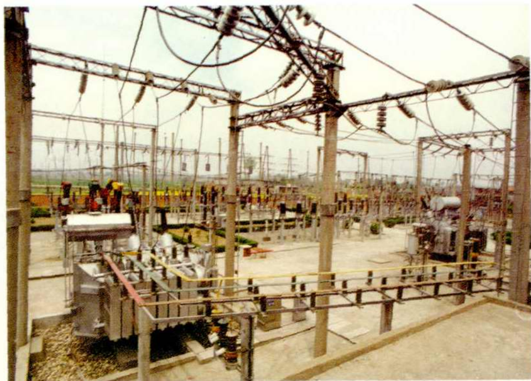
110千伏阜宁变电所
