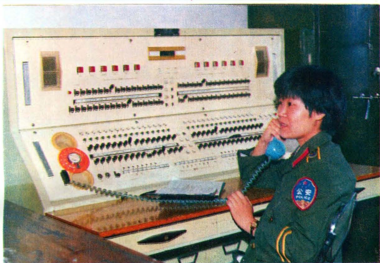
建德县公安局 30 门总机室
