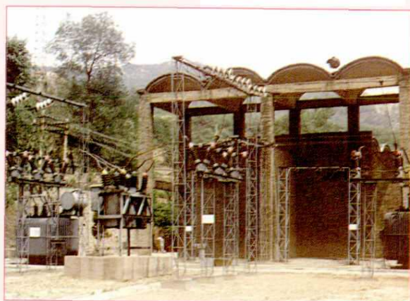
灵石煤矿 35kv 变电站
