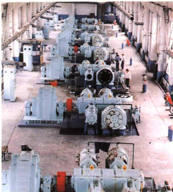
压缩机厂房 4M12-100/42 型压缩机
