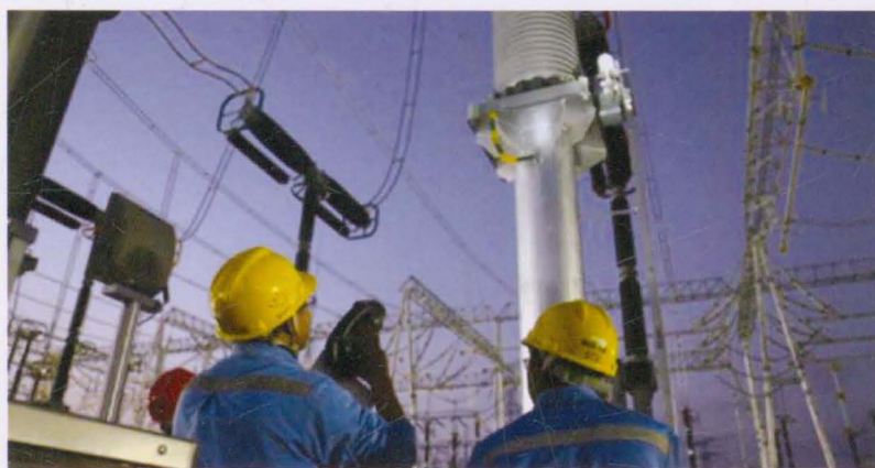
2008年8月29日，500千伏博尚开 关站投运
