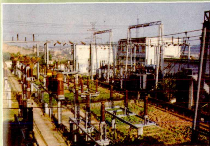
▲ 县城 110KVA 输变电站
