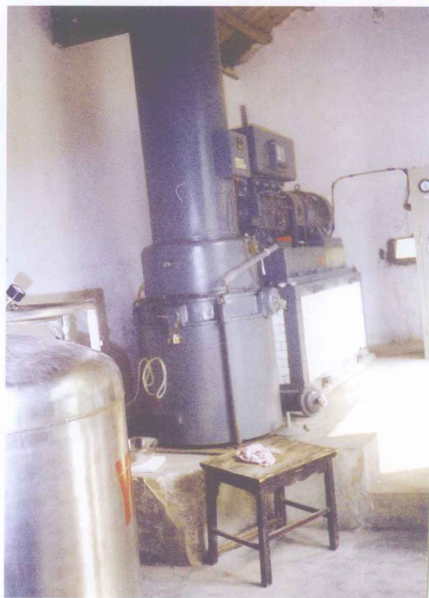
▲ 印江自治县液氮厂车间一角
