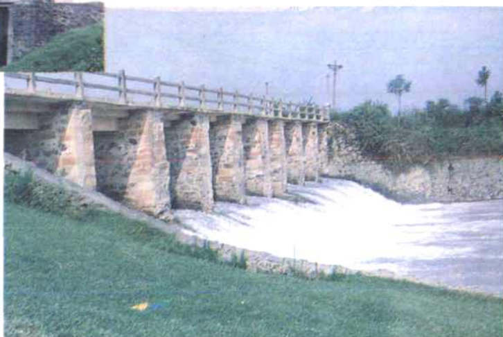
石门街水电站
