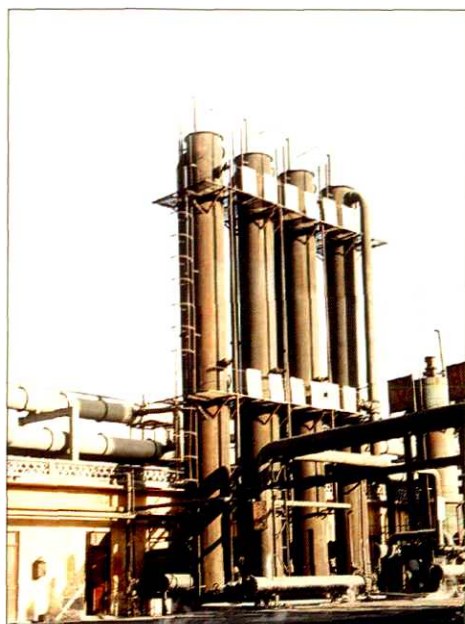
煤气回收装置
