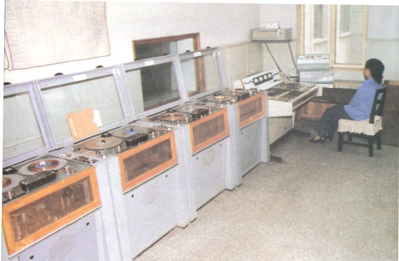
▲新建广播技术楼内的电台增音室。
