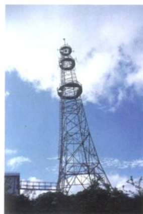
千丈岩移动电话铁塔
