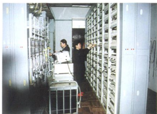
县局传输机房
