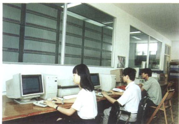
县局程控机房
