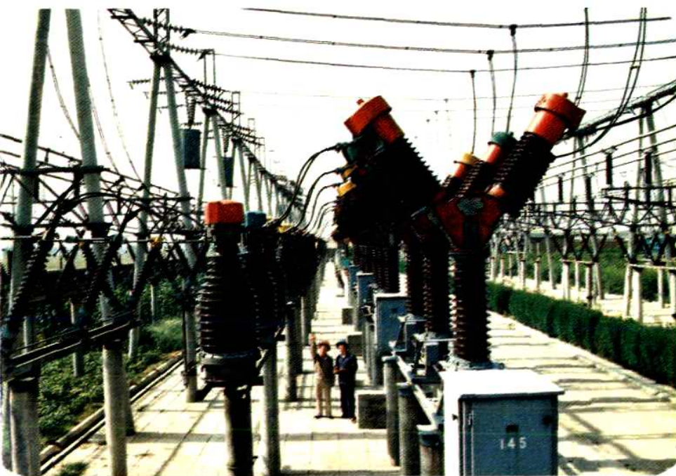
220千伏变电站巡视
