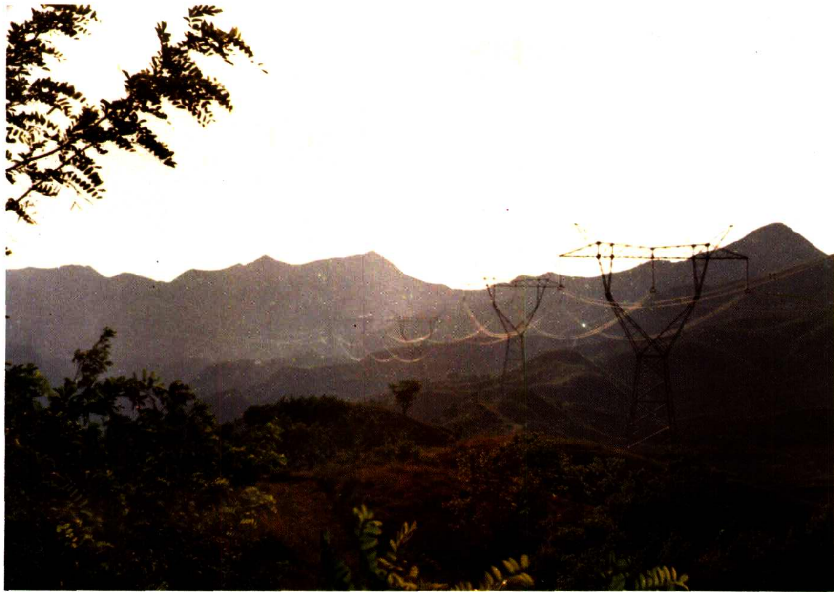
500千伏输电线路跨越太行山
