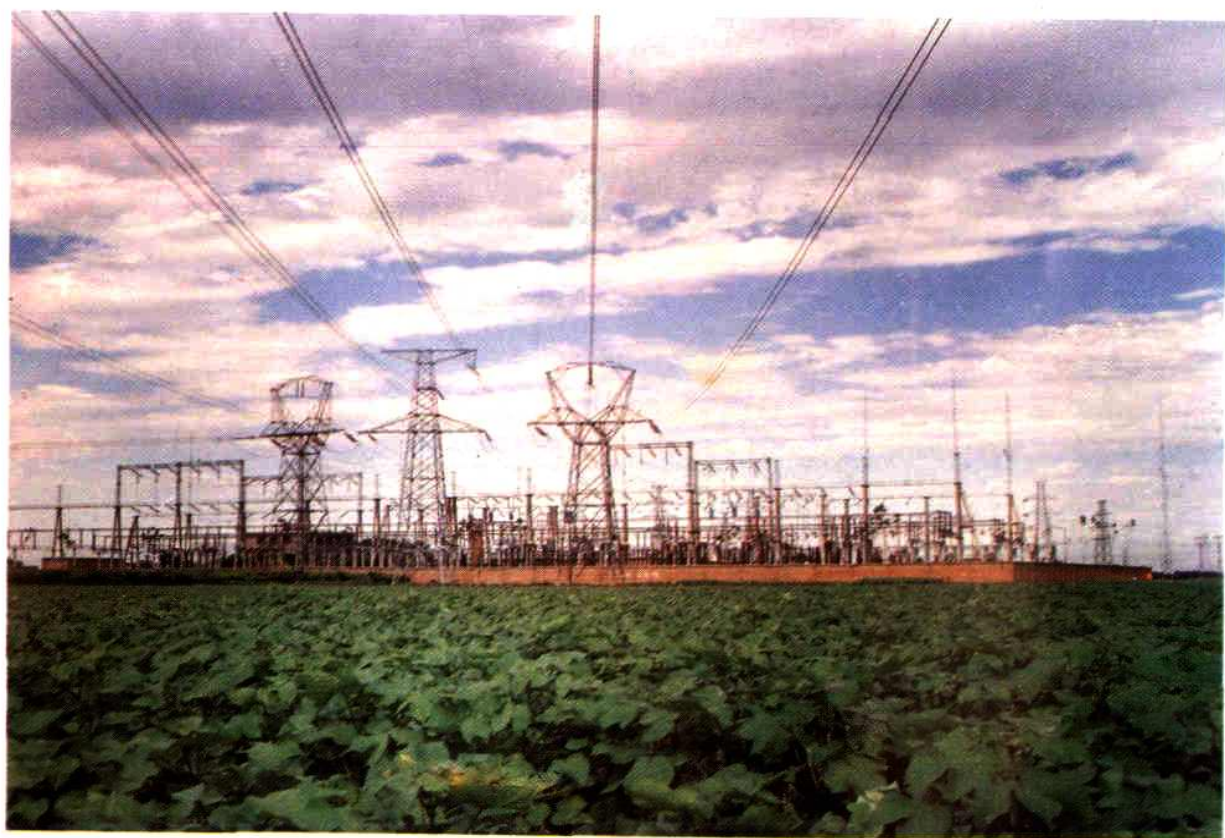
南郊220千伏变电站
