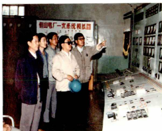
▲ 厂领导一班人在主控室了解运行情况
