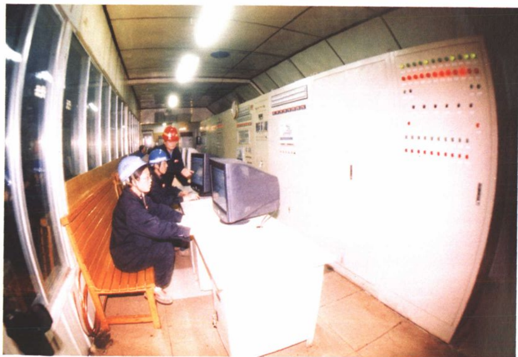
莱钢热电厂汽机车间风机控制室
