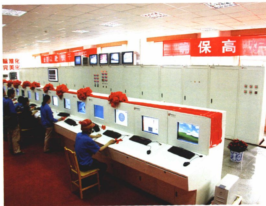
莱钢1号1880立方米高炉主控室
